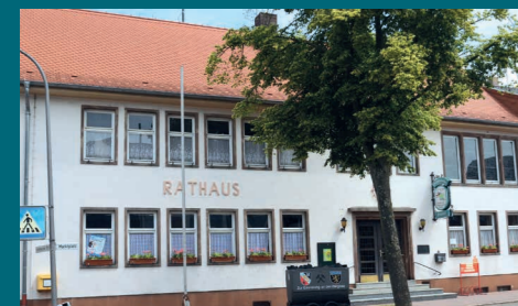
Teilsanierung Rathaus, Geschwindigkeitsreduzierung vor dem Rathaus
